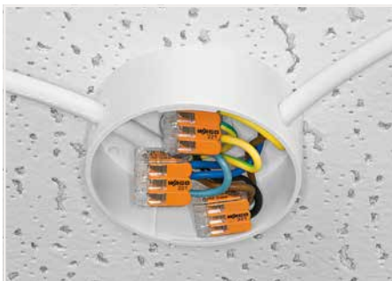
Distribution d'éclairage dans les plafonniers
