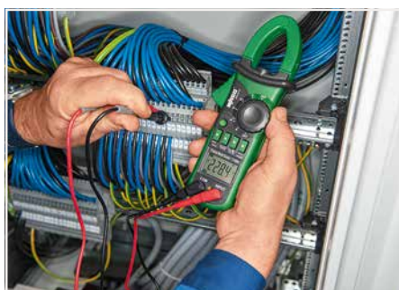
Mesure de courant dans l'armoire de commande
