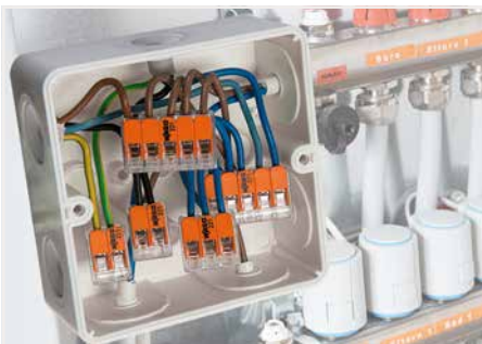
Câblage des conducteurs souples dans des boîtes d'installation pour le chauffage au sol
