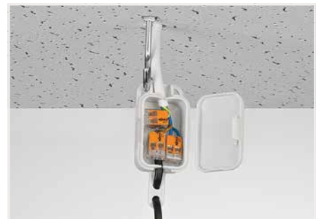
Connexion des luminaires suspendus dans les faux plafonds
